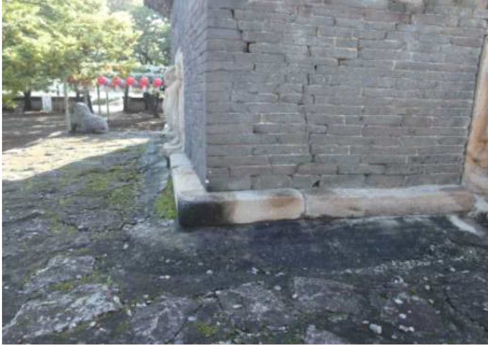
[그림 3-4] 2016 경주 지진으로 인한 불국사 벽면 균열
