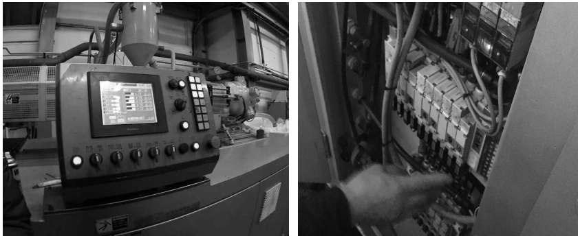
〈그림 3-8〉 사출성형기 PLC
