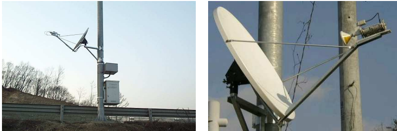
그림 4.3.2 위성 안테나 설치 사진
