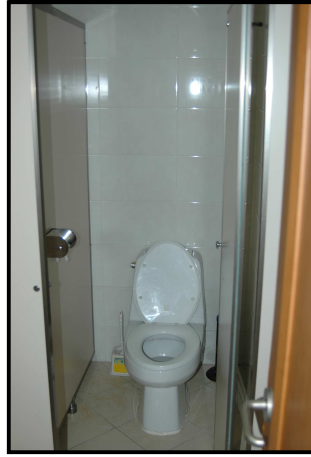
[그림 11] 핸드레일이 설치 되지 않은 화장실
